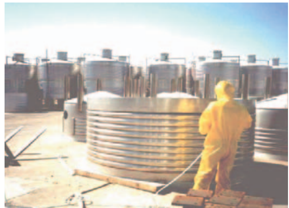
Reinigung von Weinbehältern aus rostfreien Stahl.
